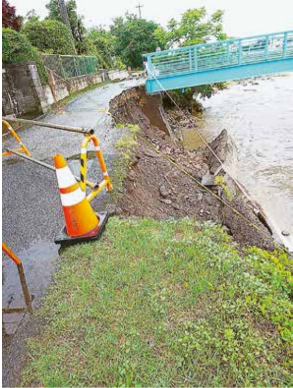
6月の豪雨災害で護岸が崩落（大胡地区荒砥川）
