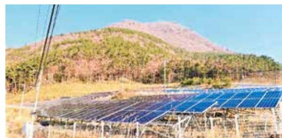
鍋割山直下に設置されている太陽光パネル
